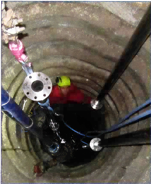
Oben: Gasmessung durch Brunnenbauer Christian. Unten: Einbau der Pumpen auf 80 m Endteufe.
